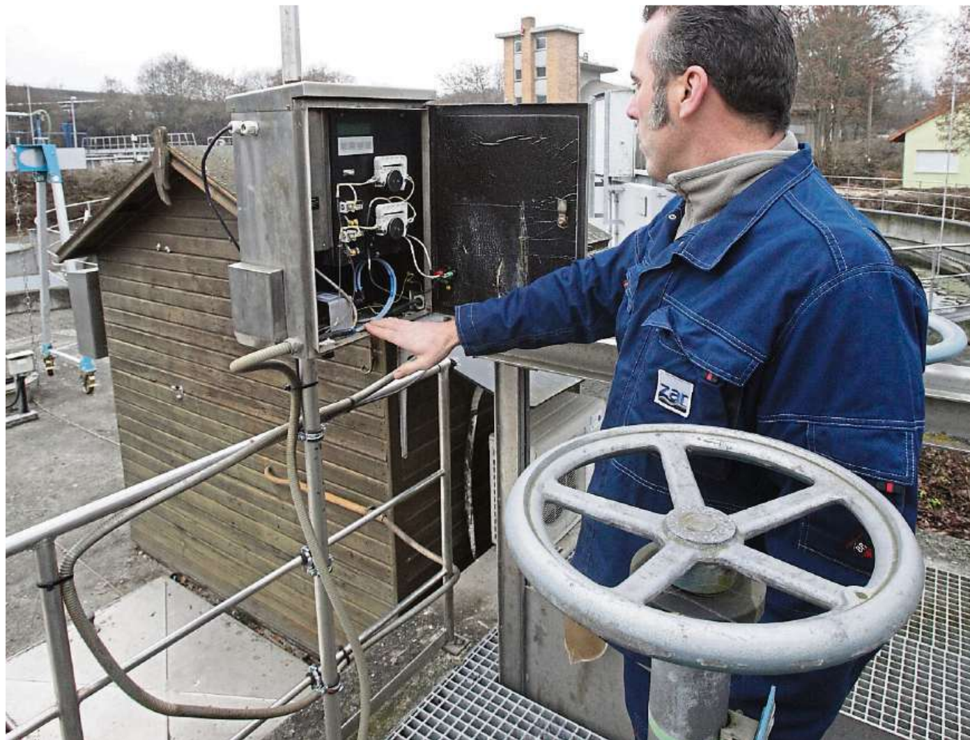
Thomas Drück an einer Messeinrichtung der Alzeier Kläranlage, in die der ZAR 2,4 Millionen Euro investiert. Foto: photoagenten/Axel Schmitz
